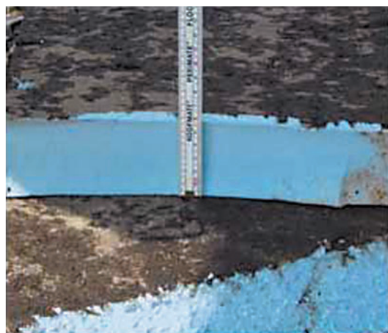
Figura 7. Corte transversal de la plancha de aislamiento de ROOF-MATE después de 32 años en servicio en una cubierta invertida fuera de la capa de impermeabilización [Dow/FIW 2004]
